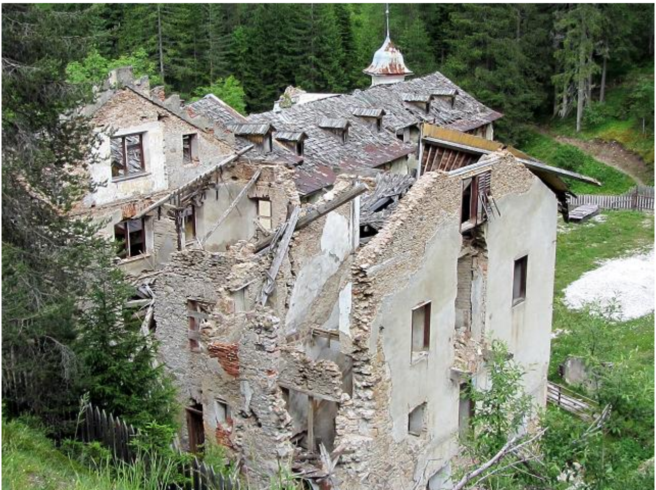
Fig. 3 - Deterioramento di un edificio lasciato a sé stesso. (© Foto propria)
